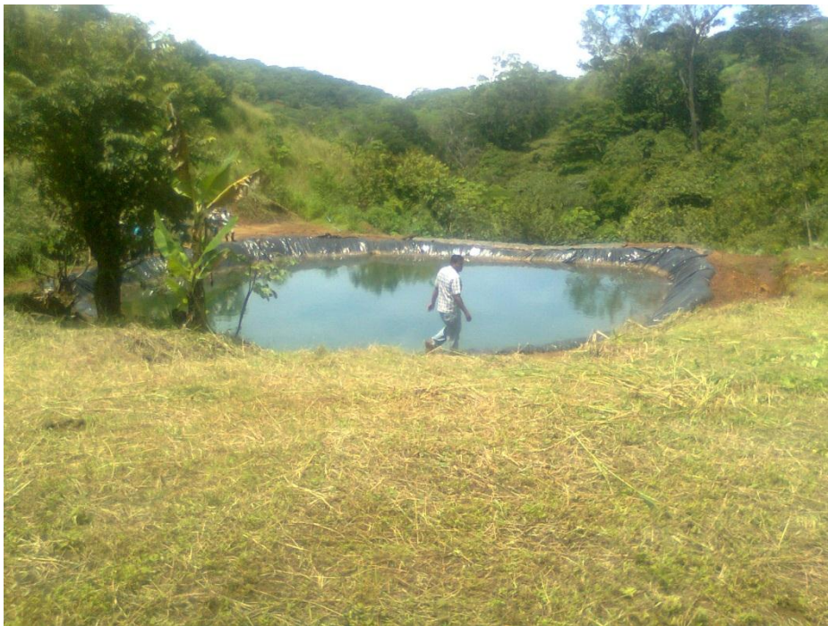
Estructura finalizada, lista para ser trabajada en el periodo seco para irrigación de cultivos.
